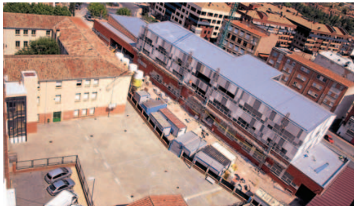
Frente al actual colegio, el nuevo edificio de La Estación ya está casi definido. ■ J. A. LALINDE
